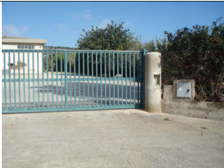
Foto punto di consegna n°2 con contatore ENEL da rimuovere e ricollocare.
