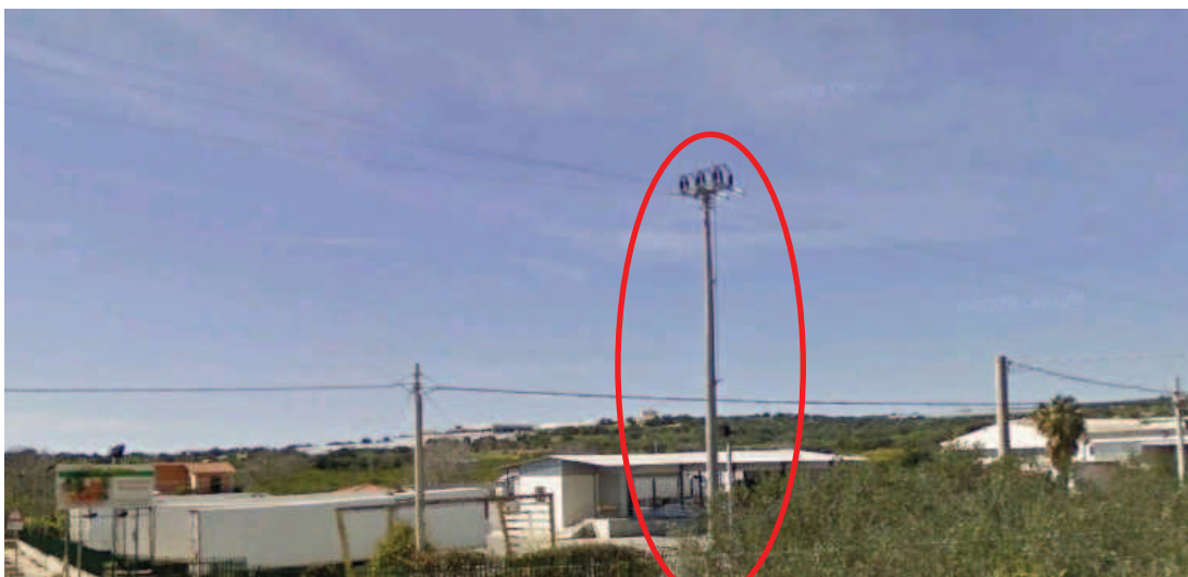
Attraversamento linea M.T. su sede stradale – Palo 7.4 da rimuovere
