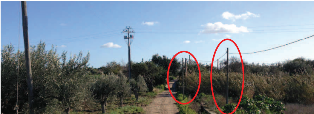
Pali di sostegno, identificati con 3.2, 3.3 e 3.4 da rimuovere e riposizionare a tergo del tracciato (identificato con 3.2N e 3.1 N)
